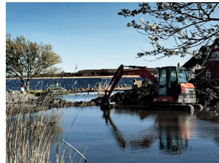
^ Familiens private billede viser tydeligt, hvor højt vandstanden stod under stormfloden i 2023 og under starten på opførslen af det nye hus
